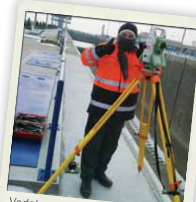
Vodohospodárska výstavba š.p., Zameranie horných vrát PLK VE Gabčíkovo
