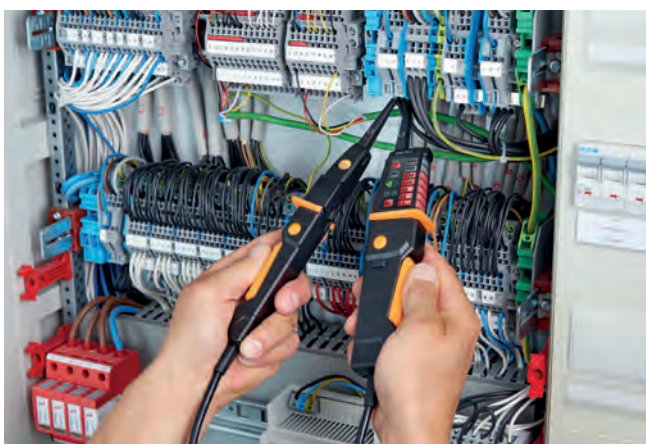
Meranie napätia v rozvodnej skrini.
