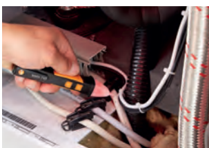
Rýchly test napájacieho napätia na kompresore.
