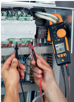
Meranie napätia v rozvodnej skrini tepelného čerpadla so zaveseným meracím prístrojom.
