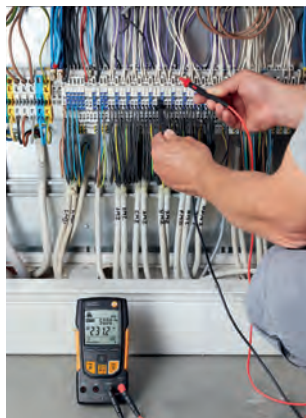
Testovanie napätia v rozvodnej skrini.
