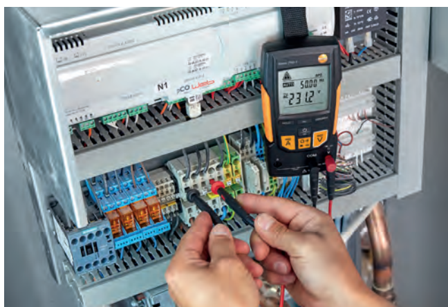
Testovanie napätia v rozvodnej skrini tepelného čerpadla.
