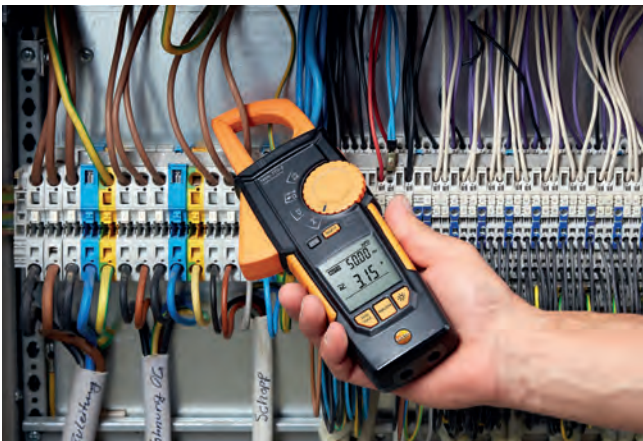
Meranie prúdu v rozvodnej skrini.
